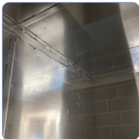
Cabina ente distributore - Milano (MI) Distributor cabin - Milan (MI)
