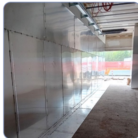
Stabilimento produttivo - Settimo Torinese (TO) Production plant - Settimo Torinese (TO)
