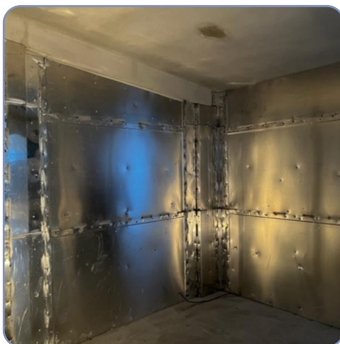
Cabina di Trasformazione MT/BT - Milano (MI) MV/LV Transformation Cabin - Milan (MI)
