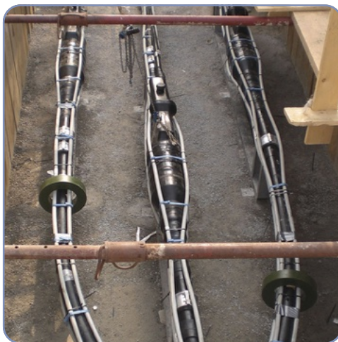
Schermatura HMCPL Buche Giunti AT - Pianezza (TO) HMCPL Shielding Holes for HV Joints - Pianezza (TO)
