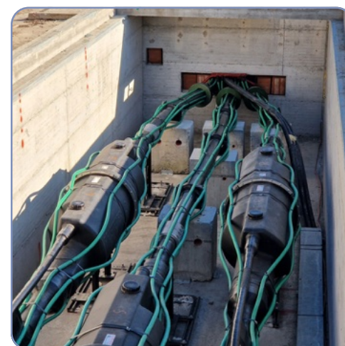
Schermatura HMCPL Buche Giunti AT - Venezia (VE) HMCPL Shielding Holes for HV Joints - Venice (VE)
